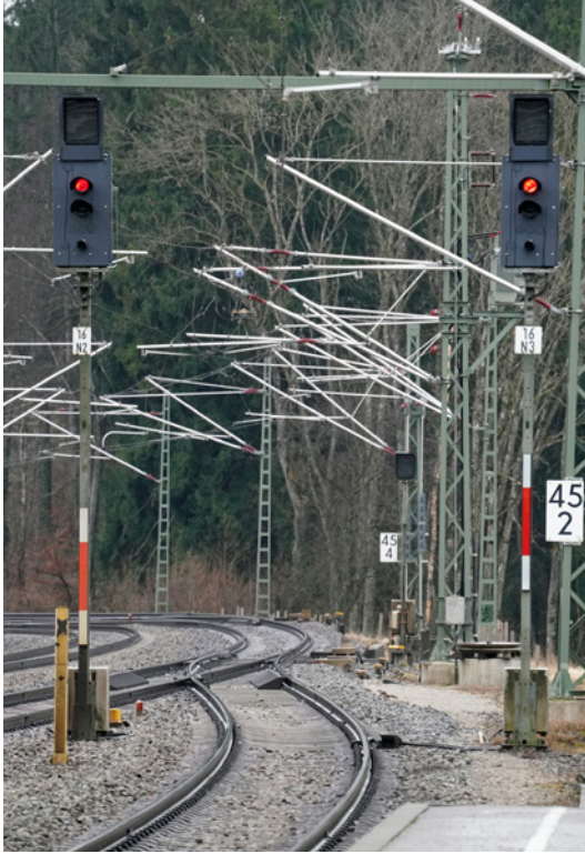
Zwei haltzeigende Hauptsignale an einer elektrifizierten Bahnstrecke (Quelle: Deutsche Bahn AG/Volker Emersleben)
