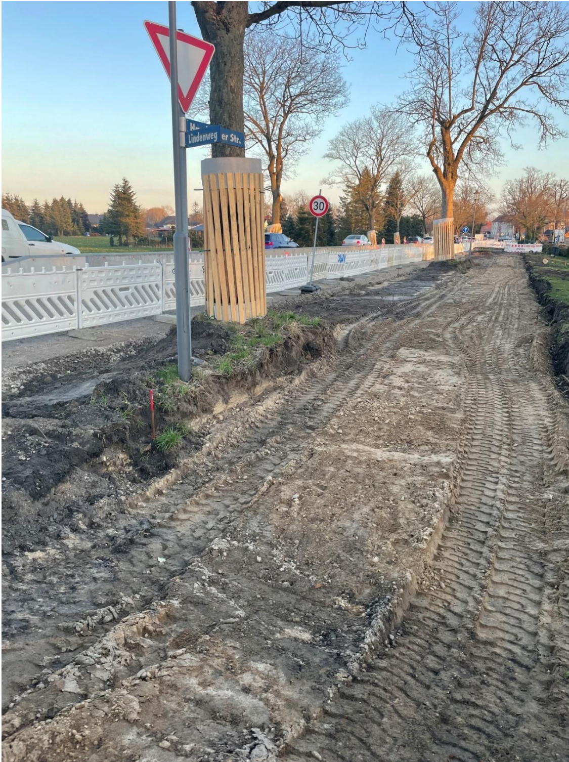
Abbildung 65: Aufgrabungen und Befahrungen im Wurzelbereich zur Neuanlage eines Radweges (B5, Abschnitt 630, 27.02.2022).
