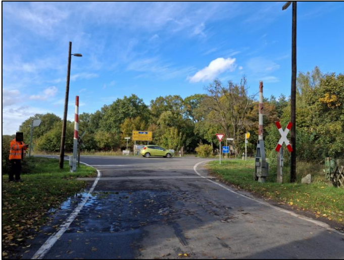
Abbildung 23: Bahnübergang Hirschfelder Straße mit Andreaskreuz und nicht betriebsbereiten Halbschranken (WSSB-Anlage zwischenzeitlich nicht mehr zulassungsfähig)
