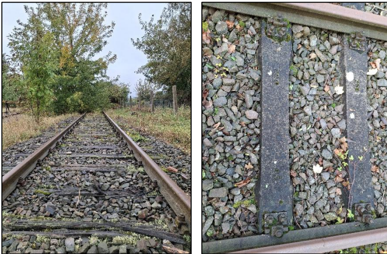
Abbildung 8: verwitterte Holzschwellen bei Wriezen und Betonschwellen in deutlich besserem Zustand bei Vevais
