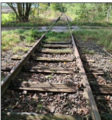
Abbildung 25: unbeschränkter Bahnübergang Waldweg (km 37,58), welcher durch Andreaskreuz gesichert ist. Keine technische Sicherung vorhanden
