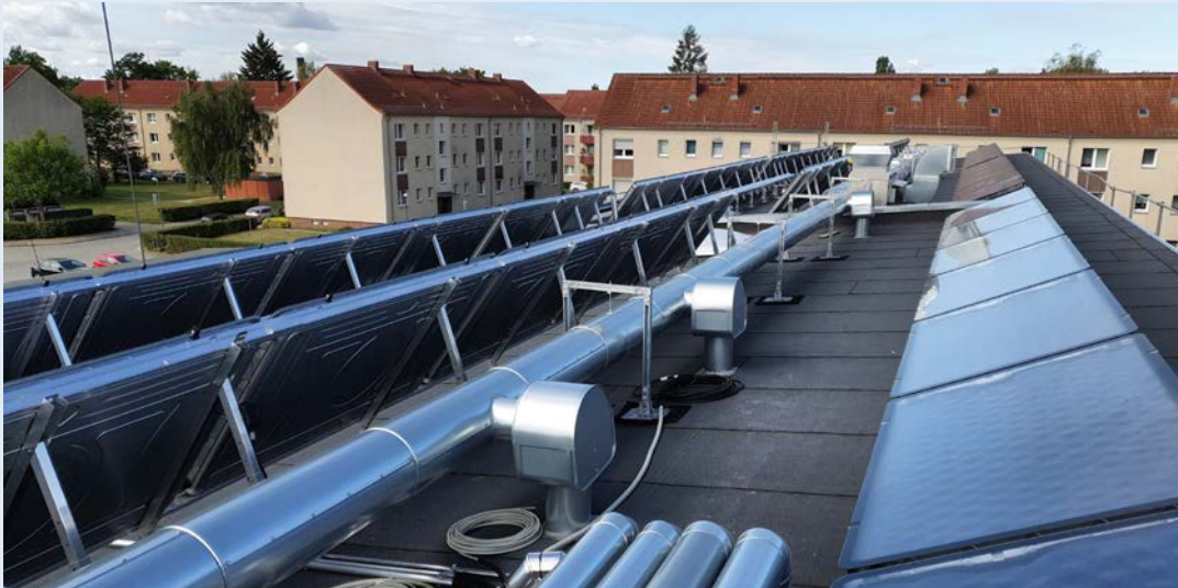
Solarthermieanlage auf einem Neuruppiner Hausdach, © Stadtwerke Neuruppin
